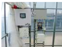
▲環境制御装置制御盤
